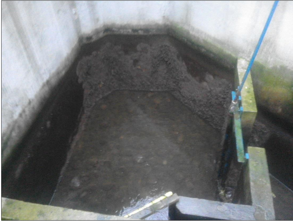
Fot 5. Zanieczyszczenia nagromadzone na zasuwie pośredniej w komorze nr 55 (19 października 2018).
