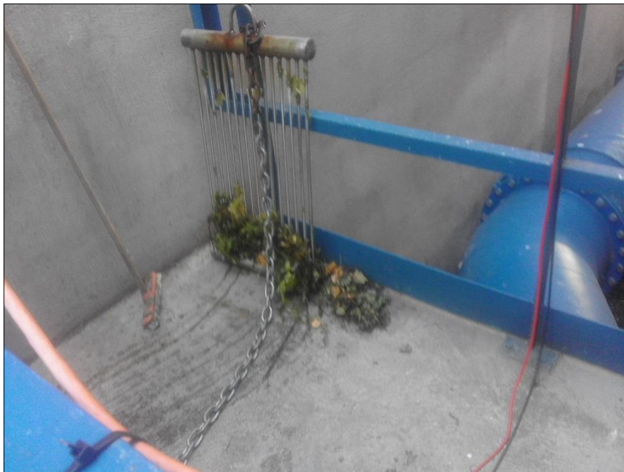
Fot 2. Ilość nieczystości, głównie szczątków obumarłych roślin, po 6 godzinach przepływu wody (jesień 2018).
